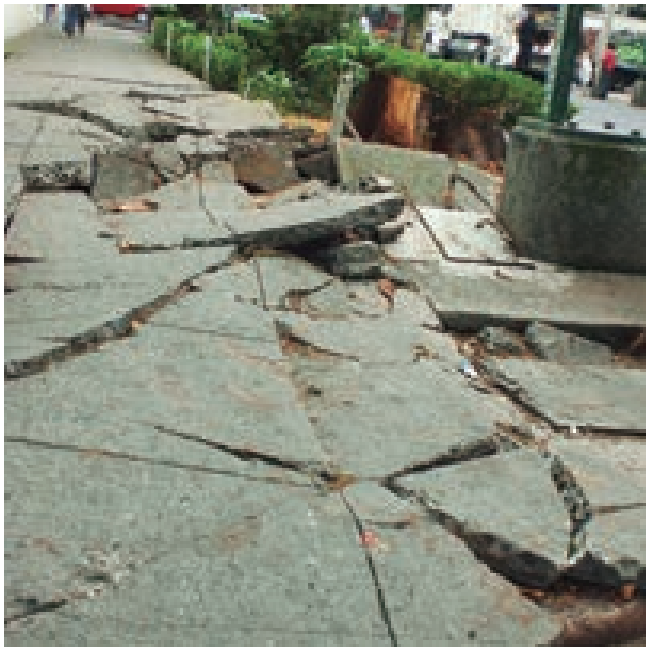
Figura 4.5 Banquetas fracturadas y levantadas.
