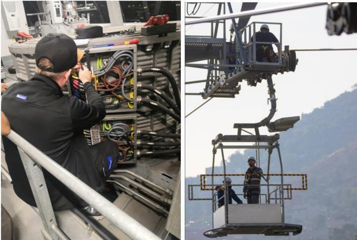
Imagen II - 65. Inspecciones anuales del equipamiento eléctrico y la línea
