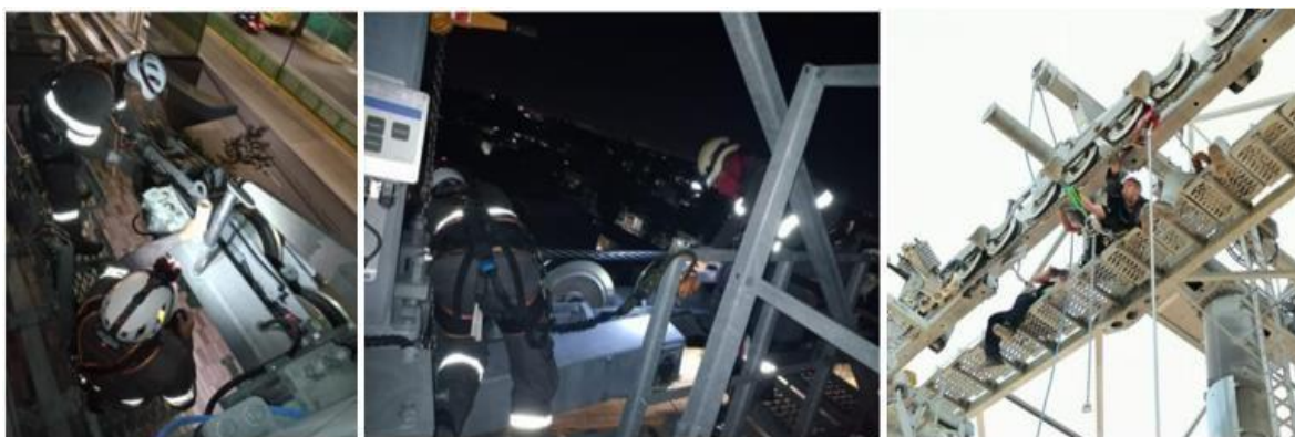
Imagen II - 66. Inspecciones anuales del equipamiento eléctrico y la línea
