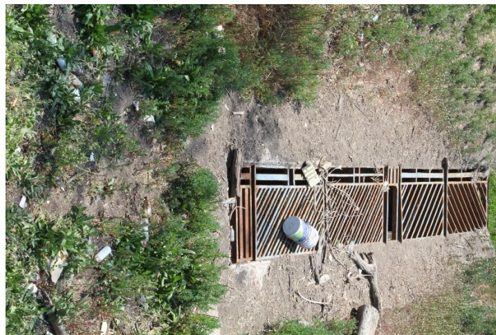
Figura 2.9 Rejillas de retención de basura de la obra de toma.
